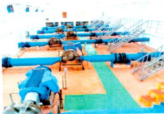
Alimentation en eau potable à Brazzaville (Congo)
