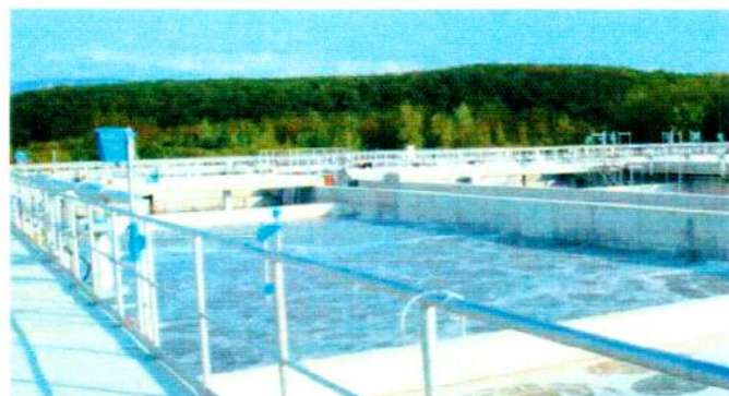
Station de traitement des eaux de la Mefou (Cameroun)
